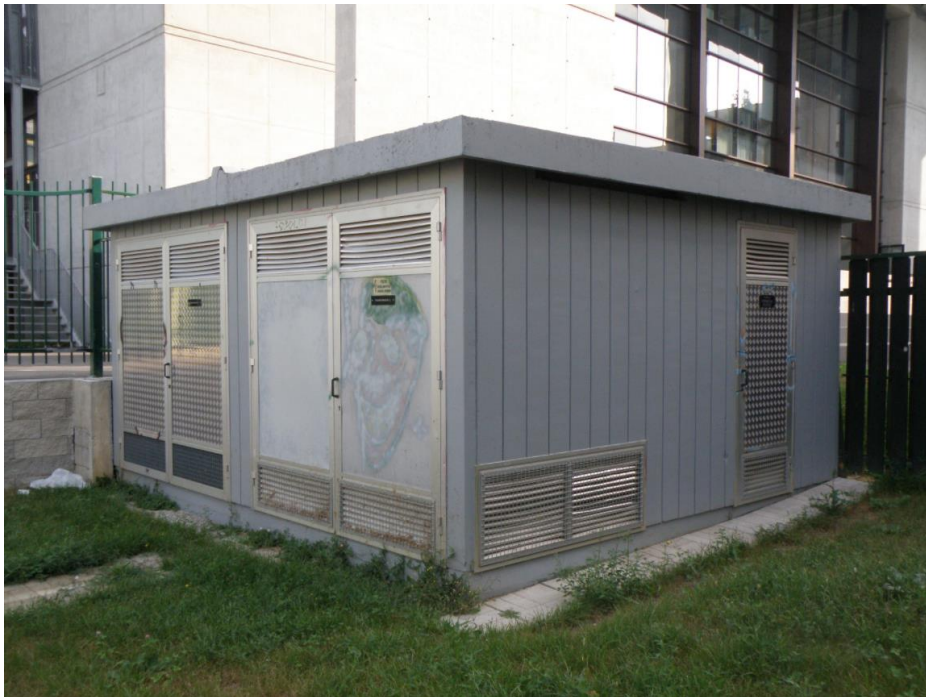
Slika 5: Transformatorska postaja GIMNAZIJA VELENJE: 2751. BHEE je za postavitev v kontejnerski izvedbi planiran za postajo.
